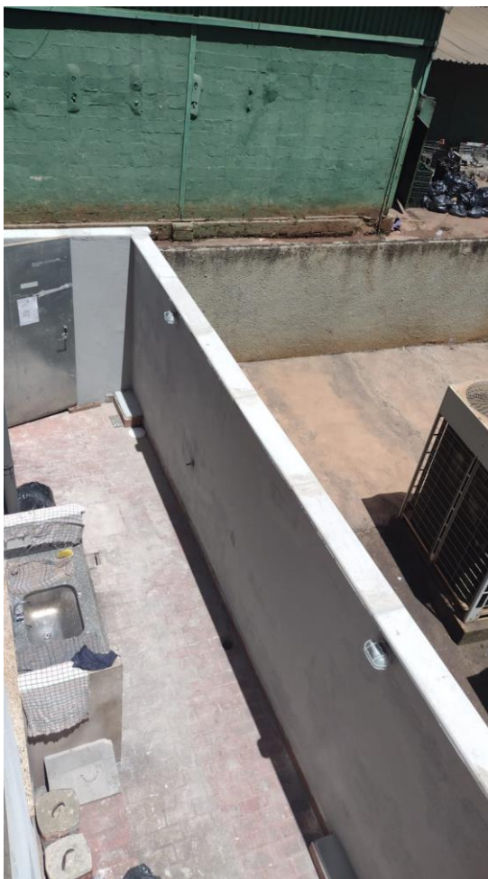
CORREDOR EXTERNO/SAÍDA EMERGÊNCIA – DIVISA COM INSS E TAMPA DE CONCRETO PARA PASSAGEM PLUVIAL
