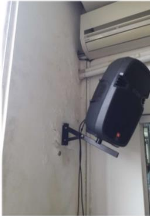
Item 18 – Trincas e infiltrações na parede da Sala de Áudio e Vídeo com característica de exposição ao dreno de ar condicionado
