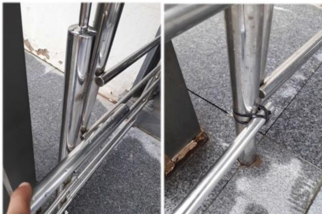
Item 05 – Guarda corpo da entrada principal com emendas
