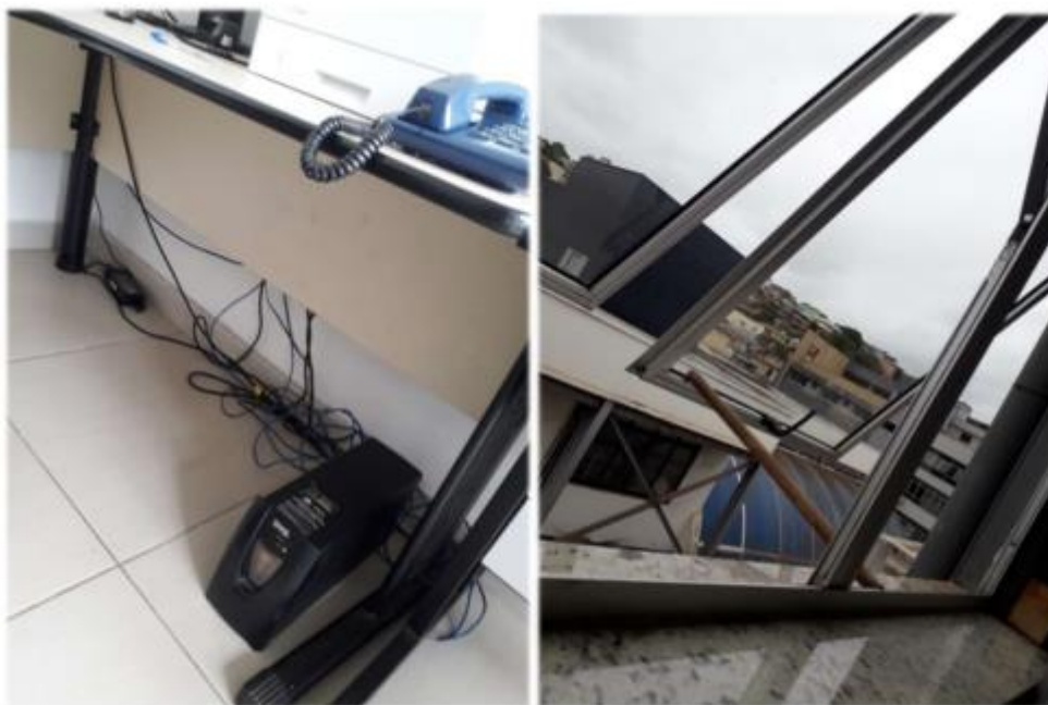
Item 67 – Desgaste na pintura da Sala do Almozarifado, infiltrações, amontoado de cabos de computador, janelas com danificações nas hastes.
