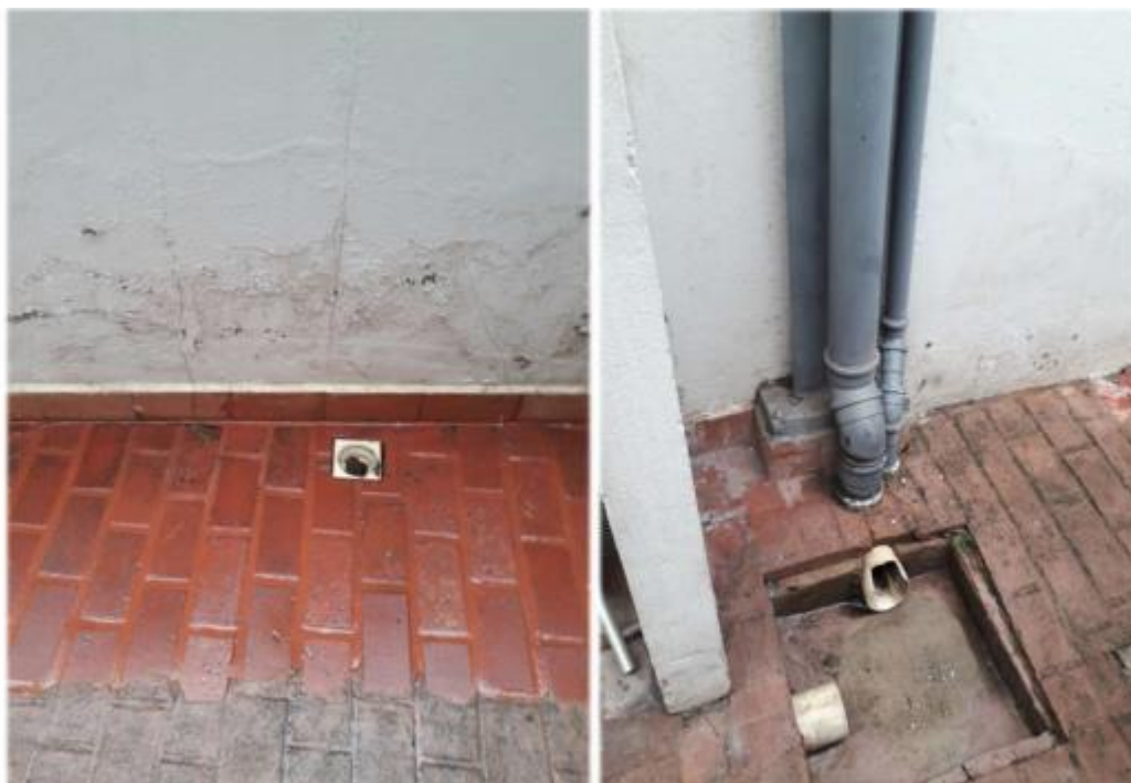
Item 06 – Acesso externo lateral direito com ralos sem o devido tamponamento e canos danificados
