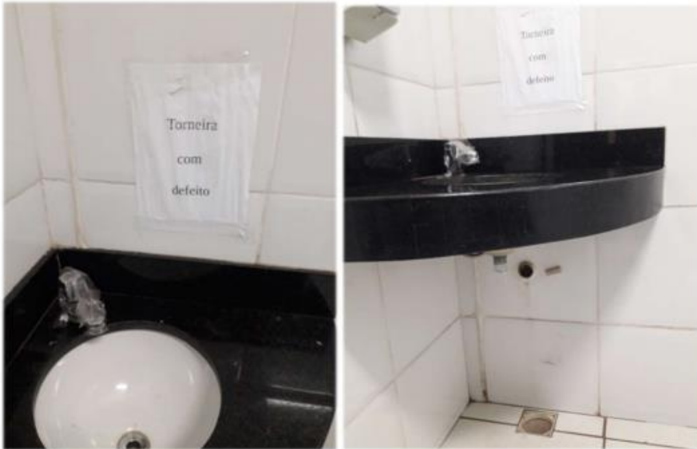
Item 64 – Pia do banheiro feminino sem instalação de sifão, válvula de descarga com defeito, vaso inutilizado, ralo de escoamento de água entupido, e porta de entrada danificada
