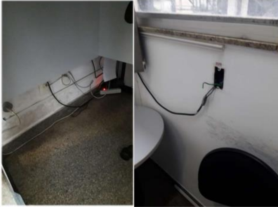
Item 58 – Desgaste na pintura da Sala do Vereador José Bernardo, amontoado de cabos de computador, tomadas elétricas danificadas, janelas com trincas e maçaneta da porta de entrada inutilizada
