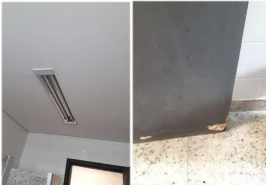
Item 65 – Pia do banheiro masculino inutilizada, lâmpadas luminária bastão grande queimada, vaso sanitário entupido/inutilizado, ralo de drenagem de água entupido e na porta de entrada com desgaste de uso contínuo.
