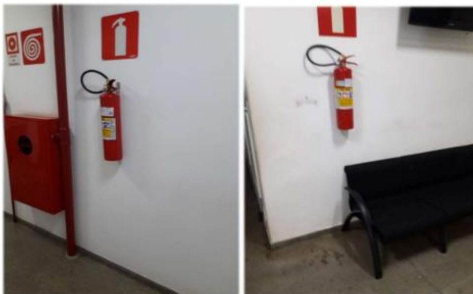
Item 40 – Falta de sinalização horizontal de incêndio no corredor
