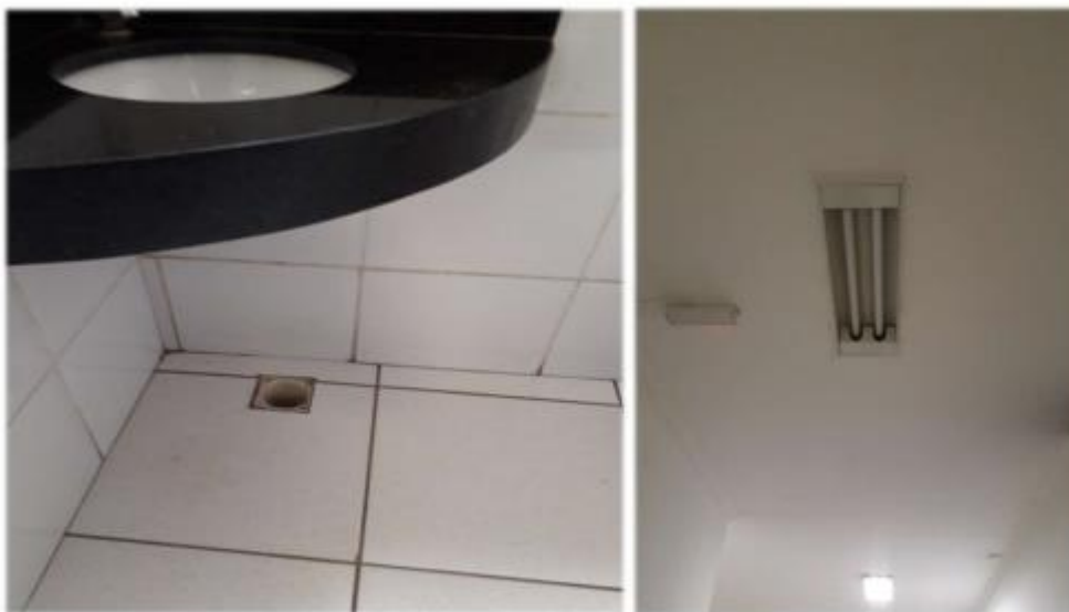
Item 39 – Ralo do banheiro feminino entupido e sem o devido tamponamento, além de 2 lâmpadas queimadas
