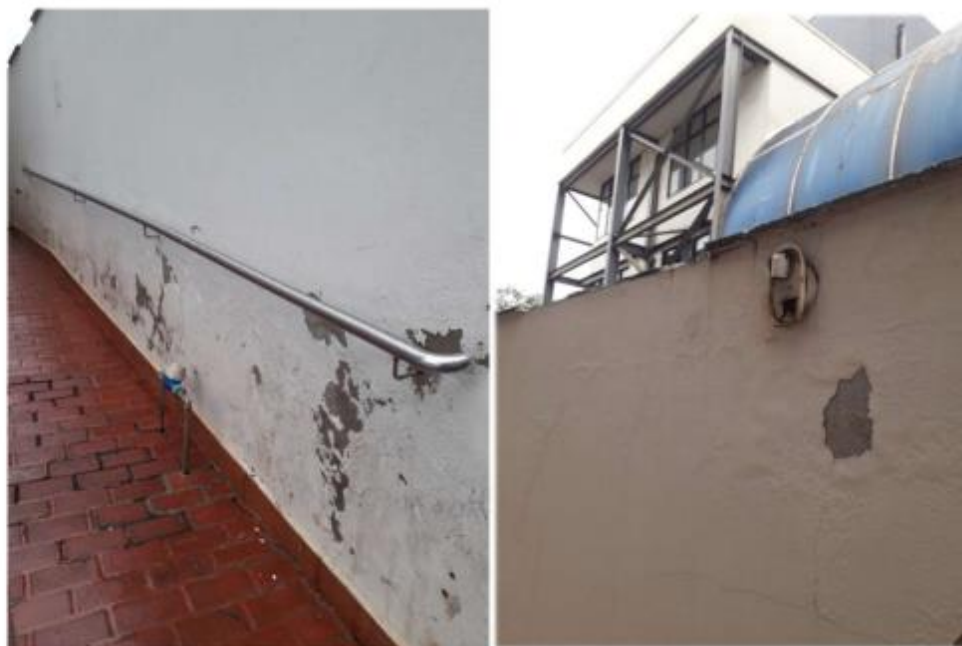
Item 03 – Muro de acesso lateral direito com danificação na pintura, pingadeiras danificadas e corrimão solto
