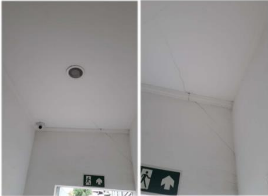
Item 30 – Luminária do acesso aos fundos com avarias por uso contínuo, paredes e tetos com trincas e manchas em função de dilatação térmica e diferença de estrutural em função ao prédio principal
