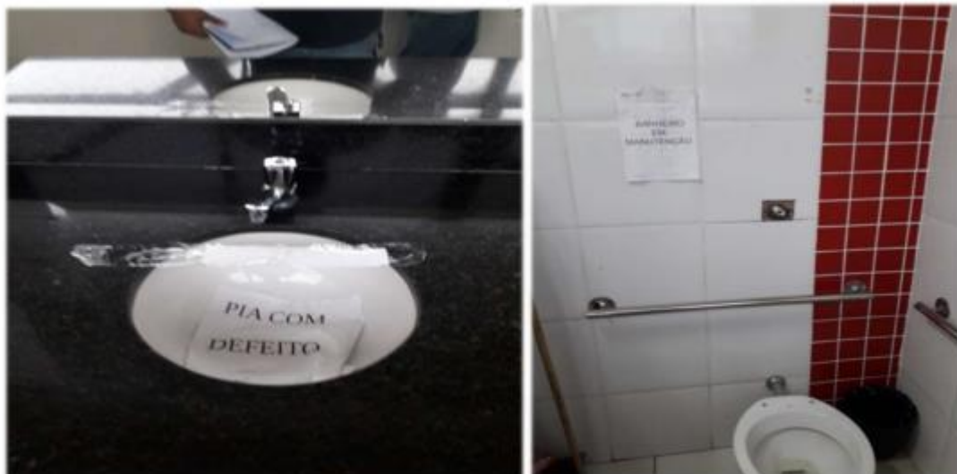
Item 62 – Torneira inutilizada no banheiro masculino, pia sem sifão instalado, ralo de escoamento de água entupido e válvula de descargas com defeito
