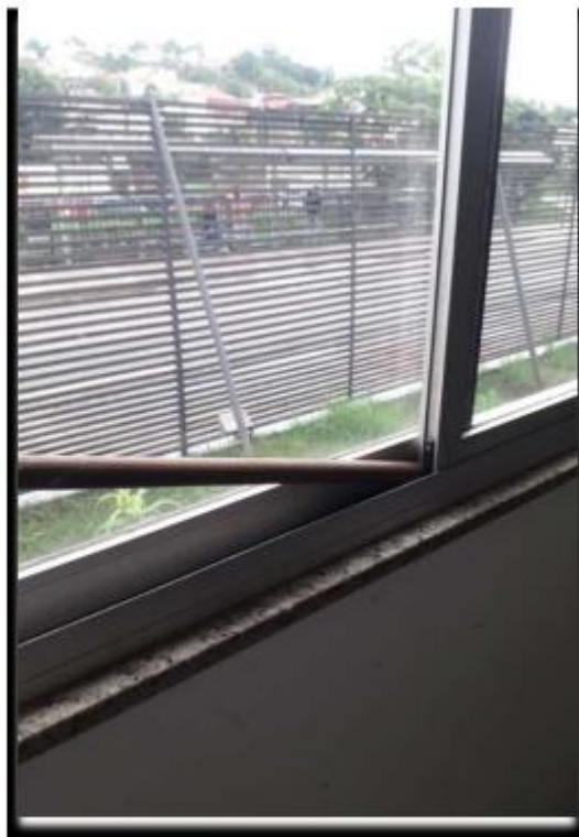
Item 20 – Janela da Sala e Áudio e Vídeo com avarias e danificações nos trincos
