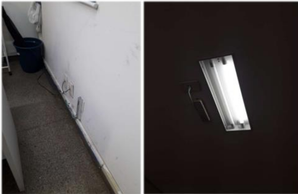
Item 55 – Desgaste na pintura da Sala do Vereador Lucas Bob, lâmpada luminária bastão grande queimada, porta da divisória emperrada e canaletas da parte elétrica com avarias
