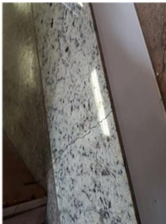
Item 24 –Trincas no acabamento em mármore do Salão Principal, localizado no primeiro andar.
