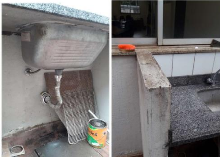
Item 08 – Tanque externo de uso dos colaboradores necessitando de manutenção e reparos para conservação do mesmo, e área impossibilitada de uso em dias de chuva por não apresentar proteção em dias de chuva
