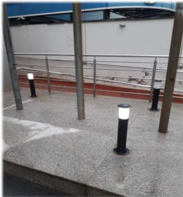
Item 01 – Iluminação da entrada principal com 1 lâmpada queimada
