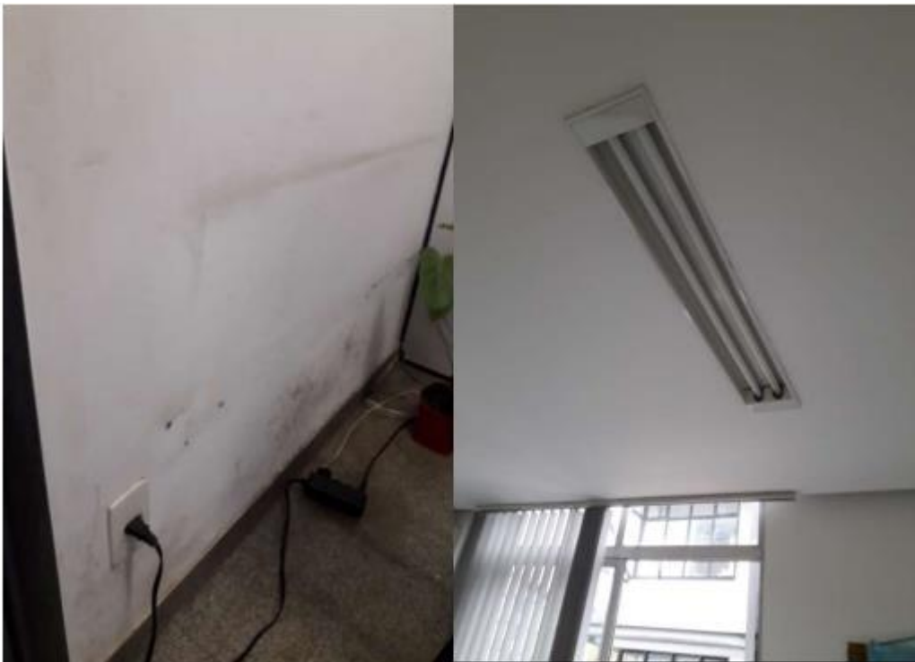
Item 45 – Desgaste na pintura da Sala 01, lâmpadas e luminárias queimadas e cabos de computadores amontoados
