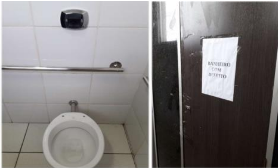
Item 22 – Vaso sanitário do banheiro masculino para deficientes interditado em função da deterioração da válvula de descarga, ralo de escoamento entupido e sem o devido tamponamento
