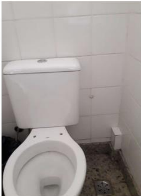
Item 31 – Banheiro dos fundos sem ducha higiênica
