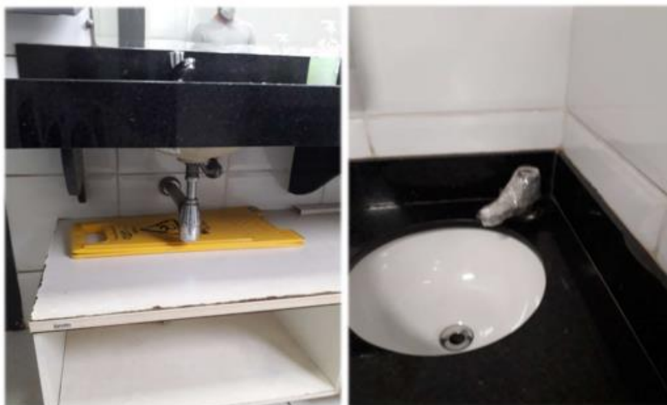
Item 35 – Torneiras e sifão da pia do banheiro masculino com avarias, bem como ralo entupido e sem o seu devido tamponamento
