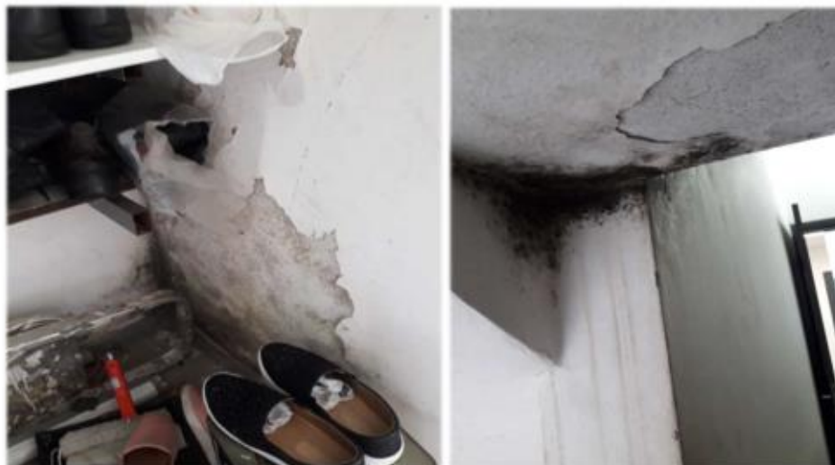
Item 34 – Manchas de mofo e sujeiras por uso contínuo nas paredes do depósito localizado aos fundos, além do armazenamento indevido dos pertences dos colaboradores
