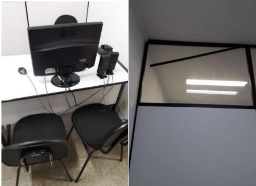
Item 59 – Desgaste na pintura da Sala do Vereador Igor Souza, borrachas das divisórias de ambiente e canaletas de cabeamento danificadas, e lâmpadas luminária bastão grande queimadas.
