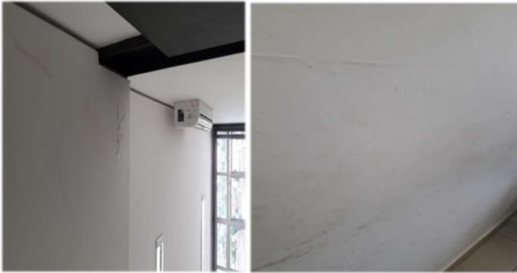
Item 68 – Desgaste na pintura da Sala da Contabilidade e infiltrações.
