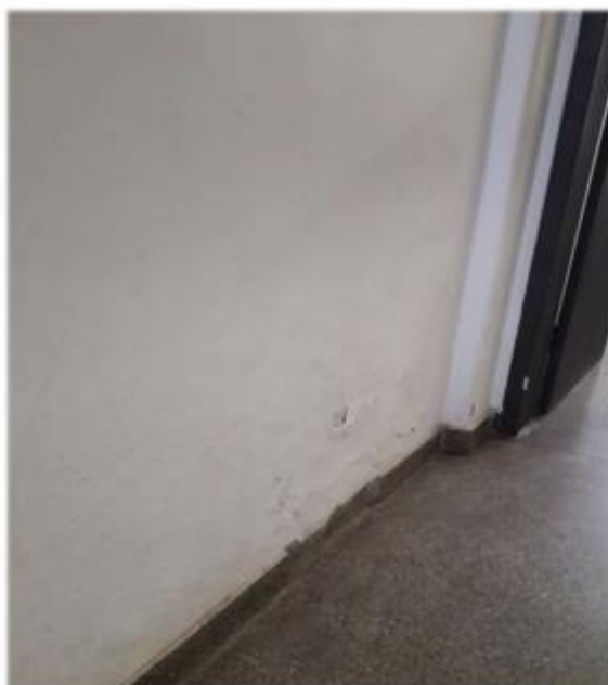
Item 41 – Paredes próximo ao rodapé, do corredor, levemente estufadas e piso com desgaste por uso
