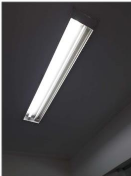
Item 16 – Luminárias da recepção queimadas
