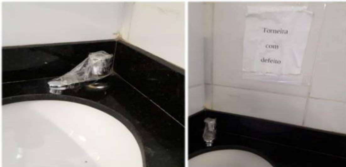
Item 37 –Torneiras do banheiro feminino inutilizadas e sifão danificado
