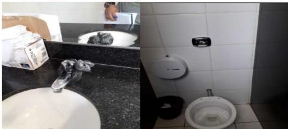
Item 23 – Vaso sanitário do banheiro feminino interditado em função da deterioração da válvula de descarga, torneiras inutilizadas, vasos sanitários entupidos, luminárias queimadas e porta emperrada.
