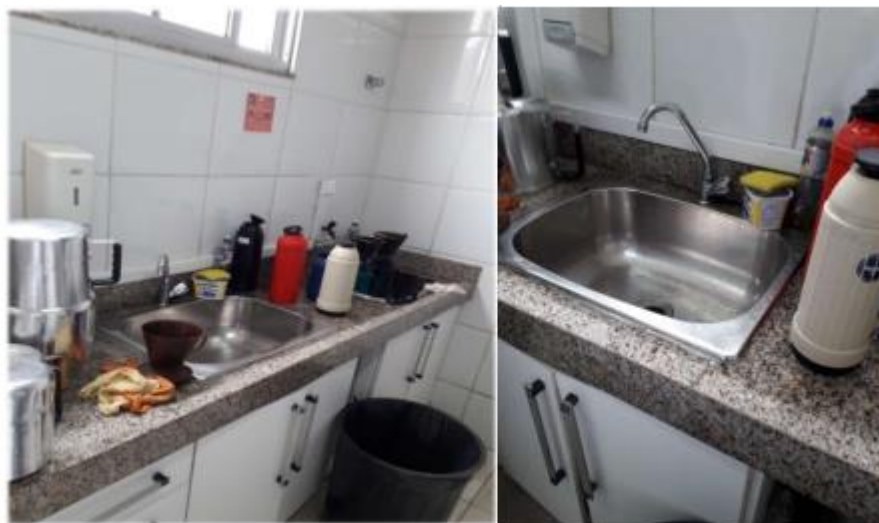
Item 42 – Pia da cozinha instalada de maneira incorreta, ocasionando em vazamentos periódicos
