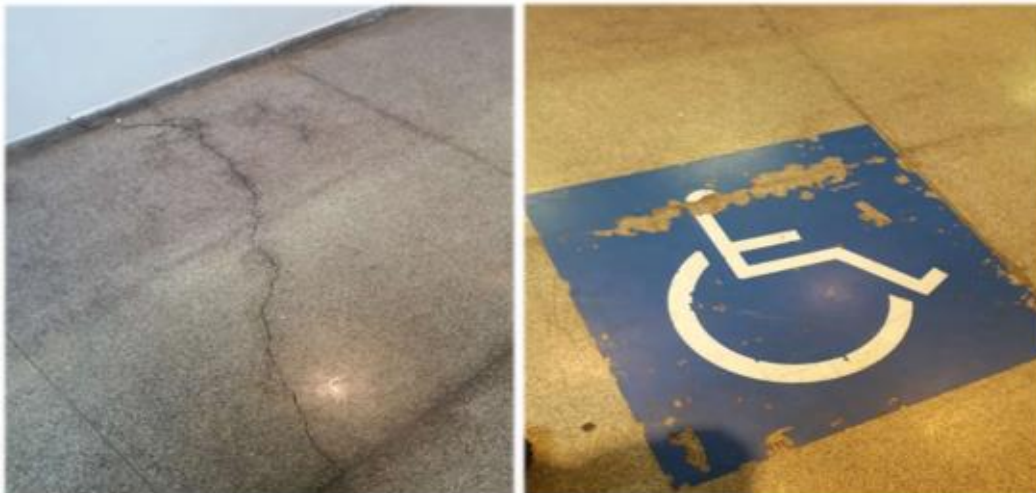
Item 28 – Trincas de dilatação no piso do Salão Principal e desgaste por uso contínuo na sinalização de acessibilidade
