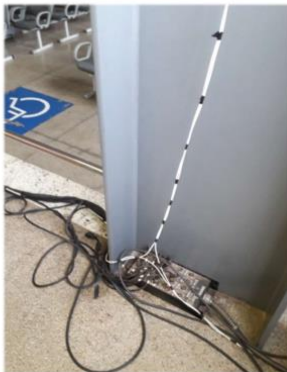
Item 25 – Cabeamento de áudio expostos no Salão Principal.
