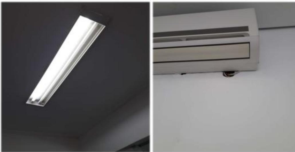
Item 61 – Desgaste na pintura da Sala do Vereador Eduardo Maranhão, janelas com trincos e lâmpada luminária bastão grande queimada
