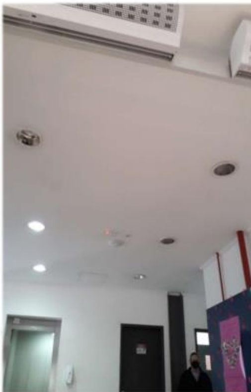
Item 17 – Luminárias do hall principal queimadas
