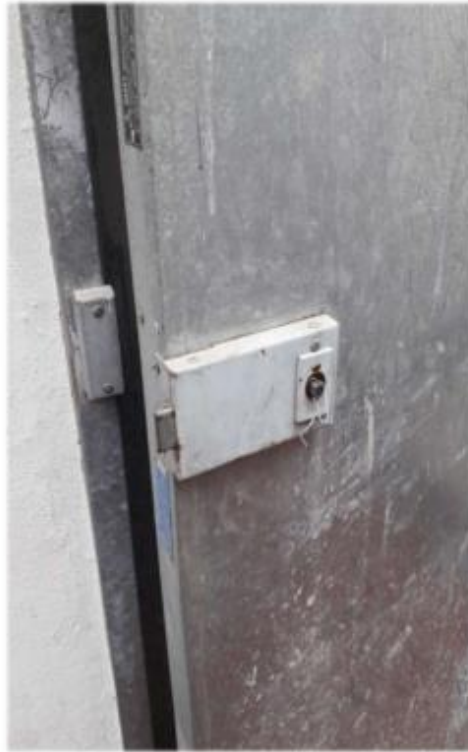
Item 10 – Fechadura da porta corta fogo do acesso externo lateral do lado direito com deteriorações
