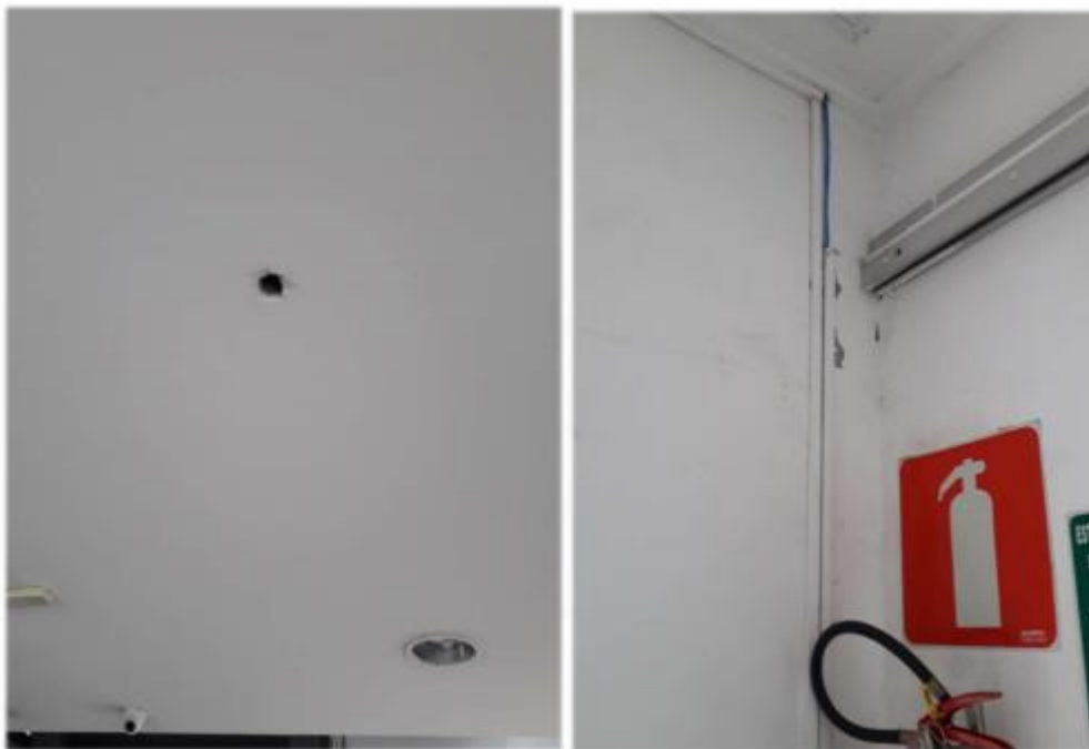
Item 15 – Furos no gesso da recepção e danificações nas canaletas da rede elétrica
