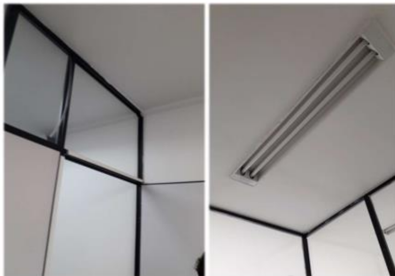
Item 47 – Desgaste na pintura da Sala do Vereador Averaldo Pica-Pau, trincos nas janelas, divisórias de ambiente sem os respectivos vidros, lâmpadas e luminárias queimadas, além de borrachas de fixação desgastadas
