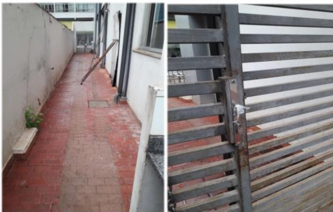
Item 07 – Acesso externo lateral direito com piso danificado e avarias na maçaneta do portão
