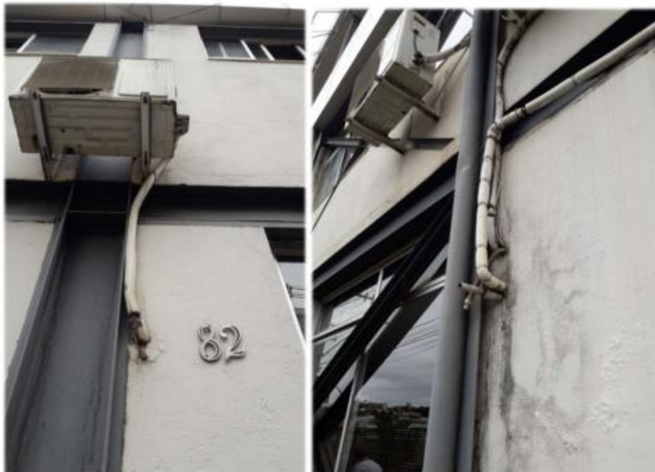
Item 12 – Condensadores de ar condicionado externo, localizados no acesso lateral esquerdo, com danificações nos drenos, ocasionando em infiltrações nas paredes
