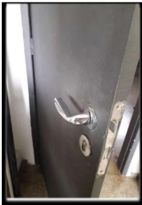
Item 21 – Maçaneta da Sala de Áudio e Vídeo com desgaste de uso
