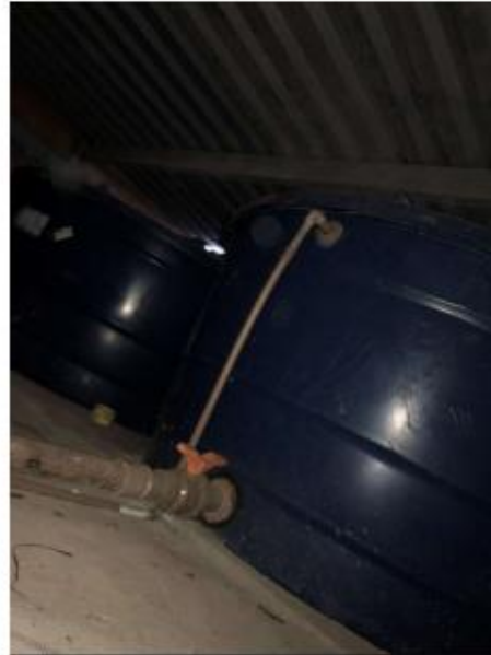
Item 74 – Sistema de abastecimento de água subutilizado devido a instalações incorretas
