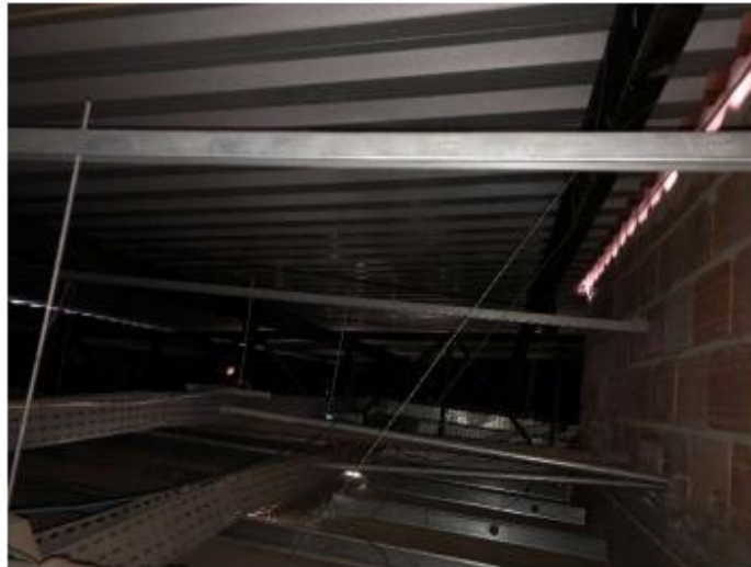
Item 73 – Aberturas no telhado em zinco provocando a entrada de água pluvial na cobertura e consequentemente no forro do 4º andar provocando mofo nas paredes do mesmo
