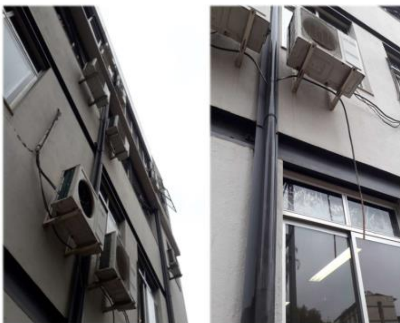
Item 09 – Condensadores de ar condicionado externo, localizados no acesso do lado direito com danificações nos drenos
