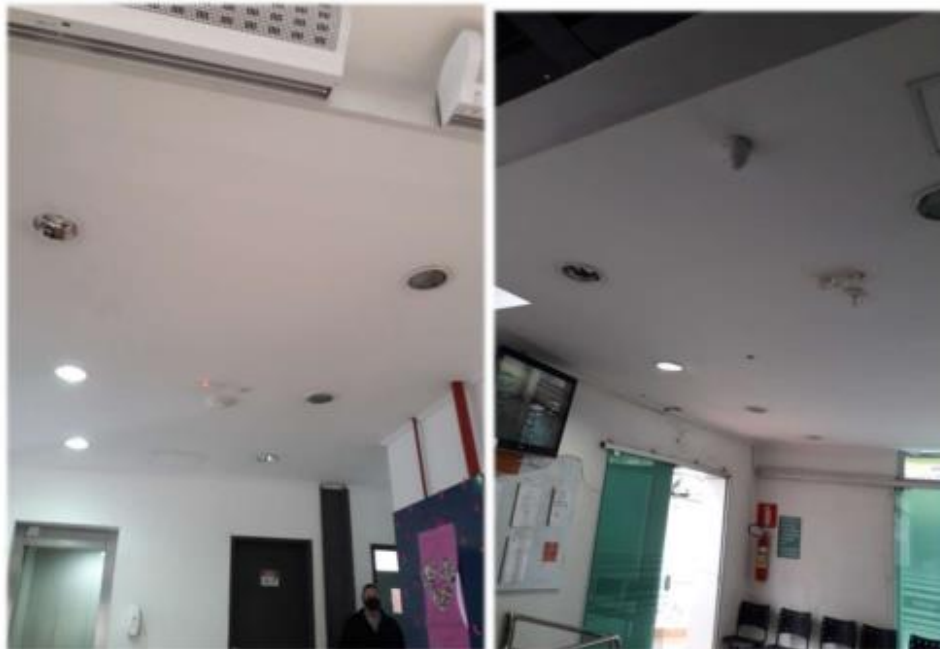
Item 14 – Luminárias queimadas na recepção
