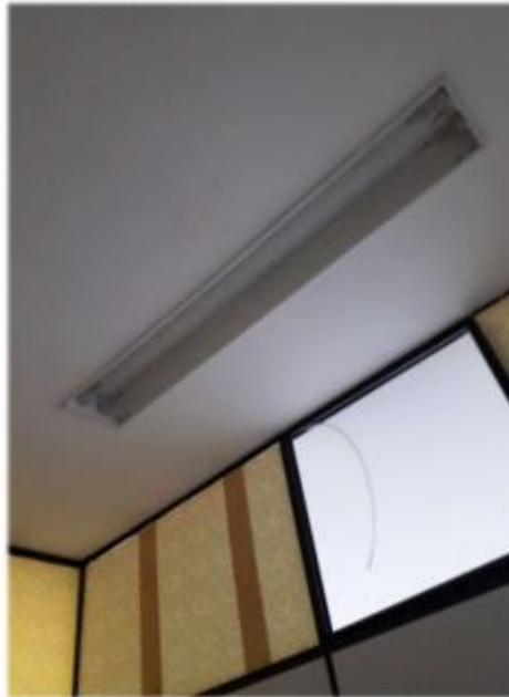
Item 60 – Desgaste na pintura da Sala do Vereador Vanderlei, divisórias de ambientes sem vidros, janelas com trincos e lâmpada luminária bastão grande queimadas
