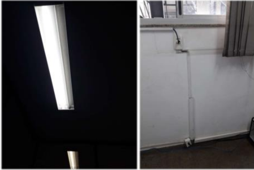
Item 54 – Desgaste na pintura da Sala do Vereador Sebastião, trincos nas janelas, cabeamento dos computadores amontoados, canaletas e tomadas desgastadas, e porta emperrada
