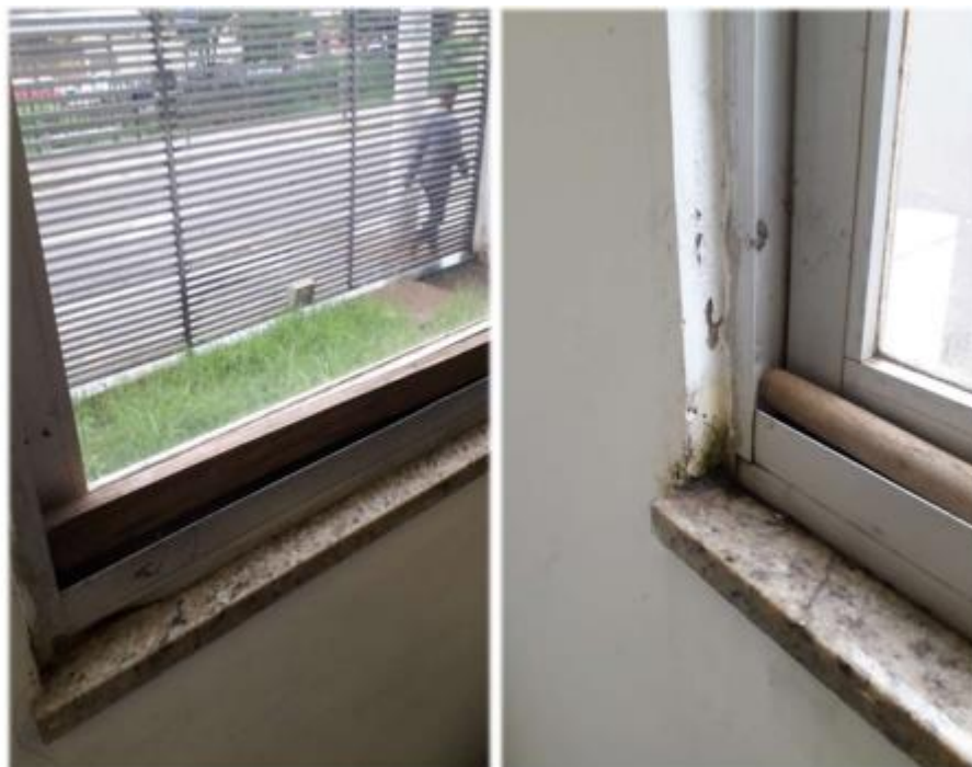
Item 26 – 4 Janelas do Salão Principal com trincos danificados por uso contínuo
