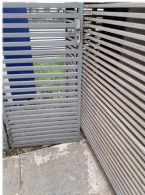
Item 11 – Portão de aço do acesso lateral esquerdo emperrado e com danificações na fechadura.
