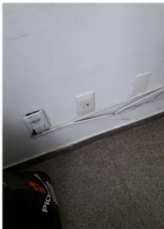
Item 49 – Desgaste na pintura da Sala do Vereador Mércio, lâmpadas e luminárias bastão grande queimadas e canaletas de cabeamento elétrico com desgaste e danificações
