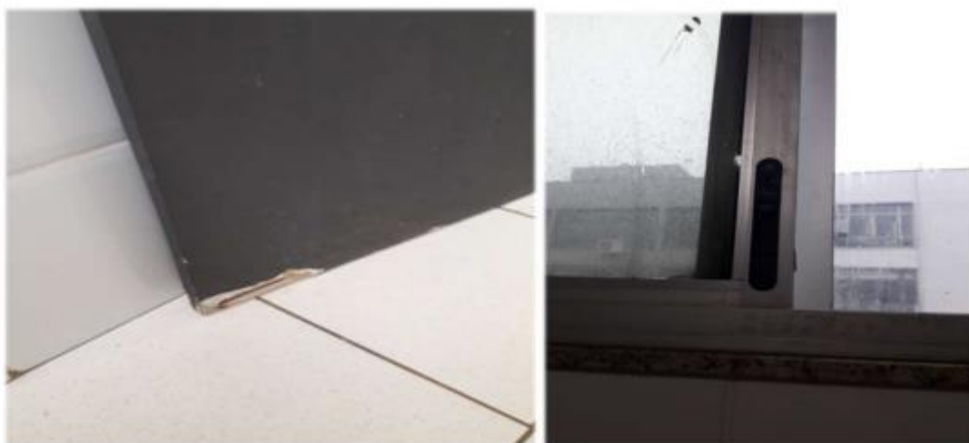
Item 63 – Janelas do banheiro masculino com trincos e portas danificadas
