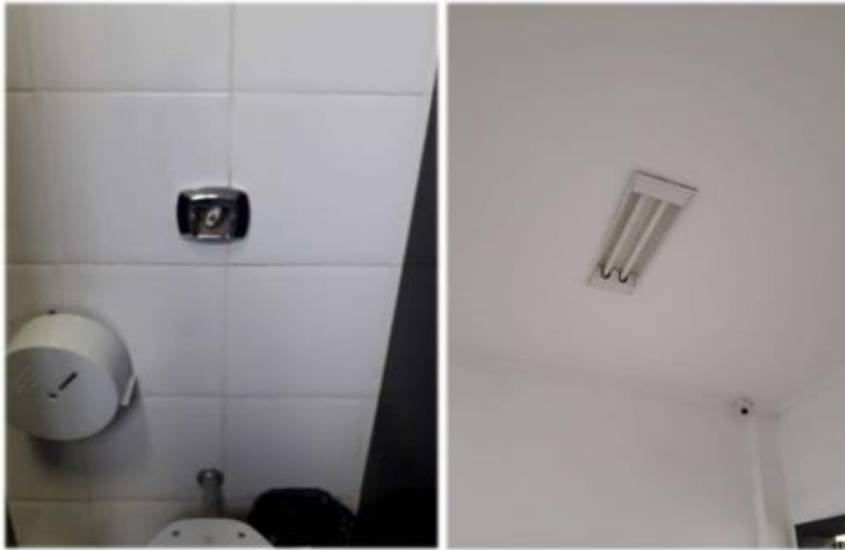
Item 36 – Válvulas de descarga do banheiro masculino com avarias, além de lâmpadas bastão queimadas
