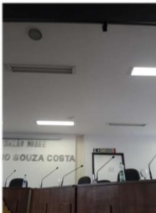
Item 27 – Trincas ao entorno das luminárias no Salão Principal, bem como interruptores danificados, espelhos de tomadas e forro com avarias, e tomadas sem as devidas identificações de voltagem
