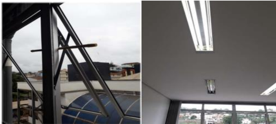
Item 70 – Desgaste na pintura da Sala do Departamento Pessoal, lâmpadas luminária bastão grande queimadas e janelas com hastes danificadas.
