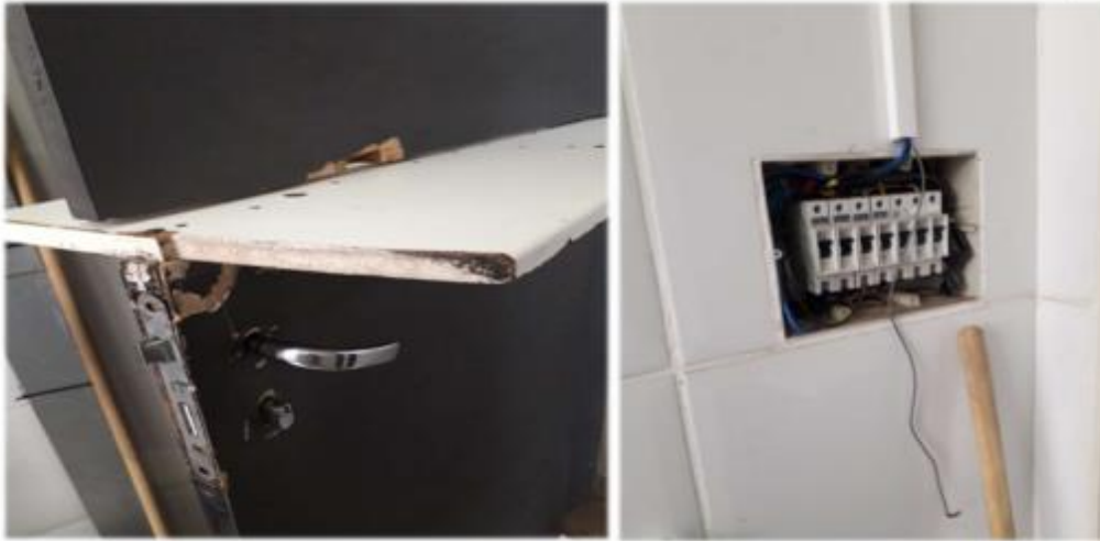
Item 44 – Porta da cozinha com danificações por uso contínuo, além do quadro de distribuição com fiação exposta, gerando risco aos colaboradores
