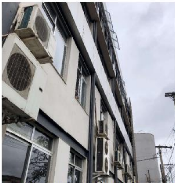
Item 13 – Pintura geral externa apresentando danificações por exposição ao tempo
