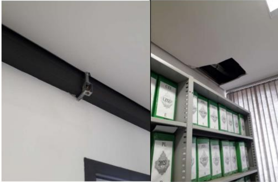
Item 72 – Desgaste na pintura da Sala do Arquivo, janelas danificadas, rede elétrica do aparelho de arquivo insuficiente, gesso do teto com avarias e lâmpadas luminária bastão grande queimada.
