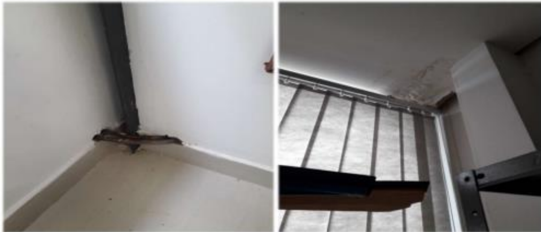
Item 69 – Desgaste na pintura da Sala da Gerência do Legislativo, portas sem os devidos fixadores de chão, lâmpadas luminária bastão grande queimadas, dreno do ar condicionado exposto e tomadas danificadas por uso contínuo.
