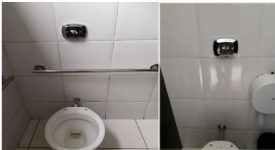
Item 38 – Válvulas de descarga do banheiro feminino danificadas por uso contínuo
