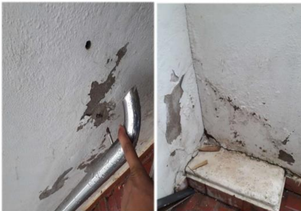
Item 04 – Muro de acesso lateral direito com danificação na pintura e corrimão solto
