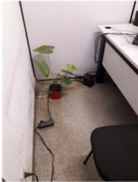
Item 46 – Desgaste na pintura da Sala do Vereador Galileu, trincos nas janelas e tomadas necessitando de manutenção/troca por deterioração de uso contínuo
