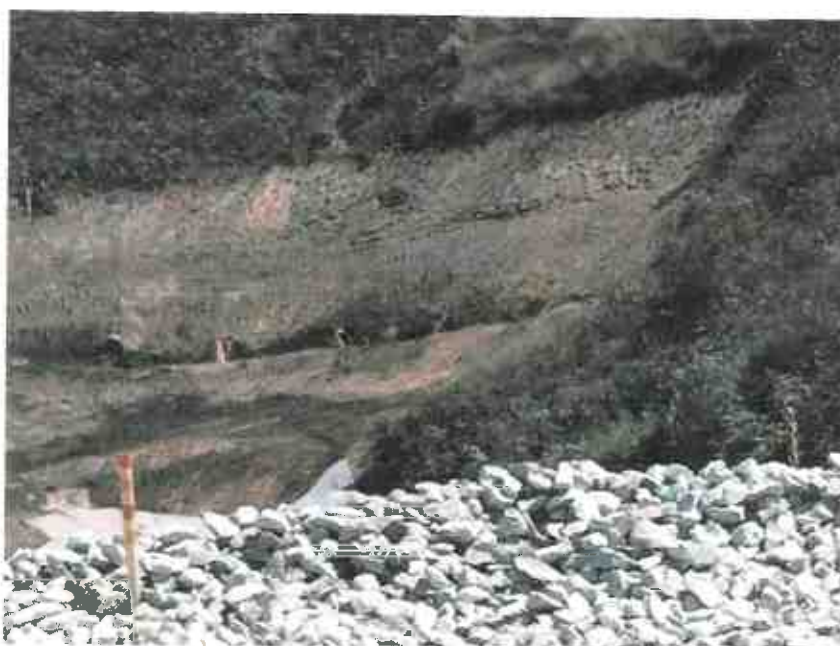
Figura 7: Vista da parte superior da ombreira direita (acima do local da obra) com fartos indícios de ocorrência de surgências (onde foram instalados os DHPs)
