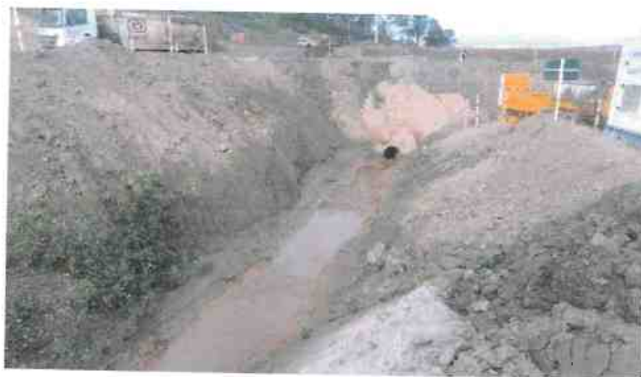
Figura 11: Vista da passagem do efluente pelo estrutura improvisada sob o aterro implantado
