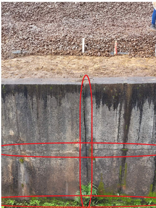
Foto 03 – Muro lateral do vertedouro, observa-se junta vertical construtiva com abertura mais aparente, sugerindo deslocamento relativo entre os dois módulos de concreto.
