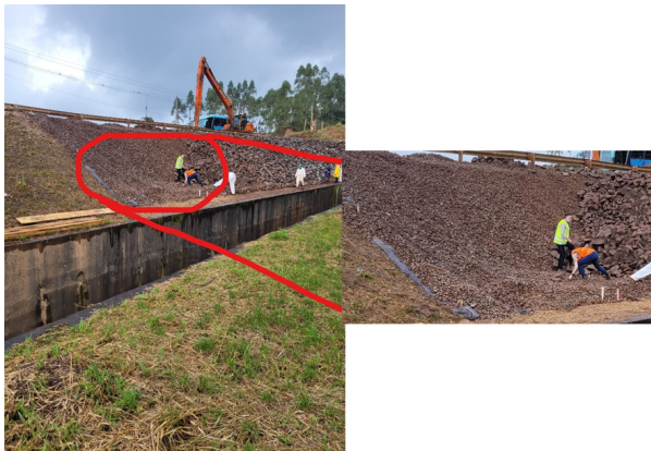
Foto 03 - Detalhe construtivo do dreno invertido proposto como solução de reforço para o talude adjacente a parede lateral do vertedouro.
