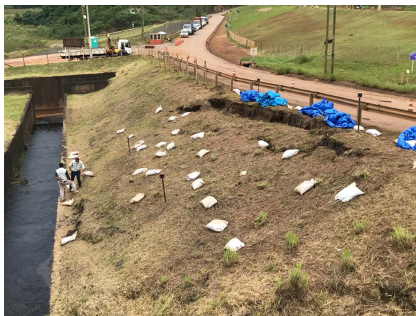
Foto 01 - Detalhe para trinca devido abatimento do talude adjacente ao vertedouro da barragem B4.
