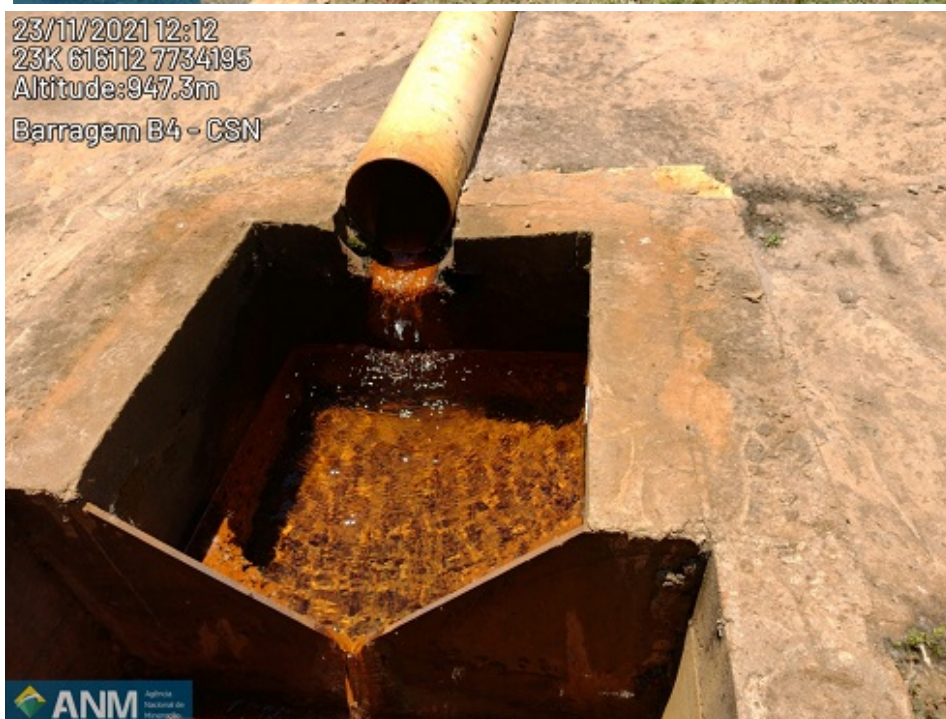
Foto 5 - Surgência monitorada no reforço do talude de jusante. água proveniente de surgência no reforço do talude de jusante (baixa turbidez).
